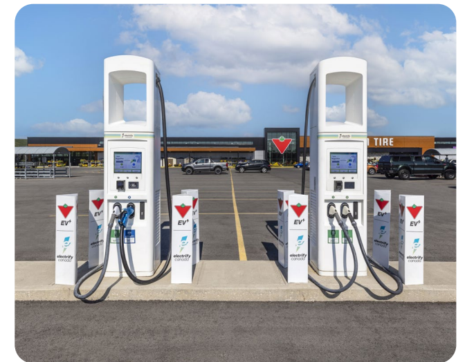
Poste de recharge pour VE à la propriété de CT REIT à Welland (Ontario).
