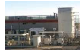
Glendale Landfill Biogas 3 MW
