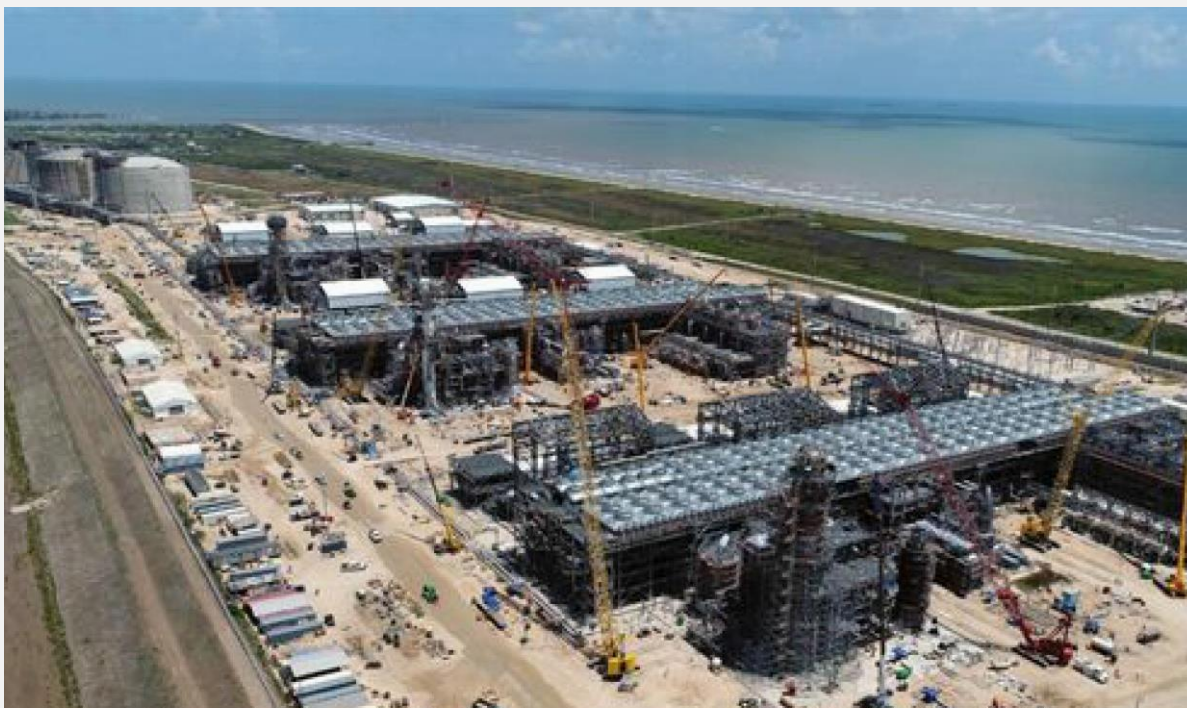
Freeport LNG LQF Site (Freeport, TX)
