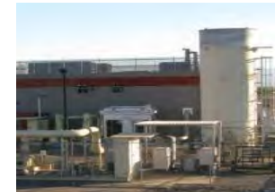
Glendale Landfill Biogas 3 MW
